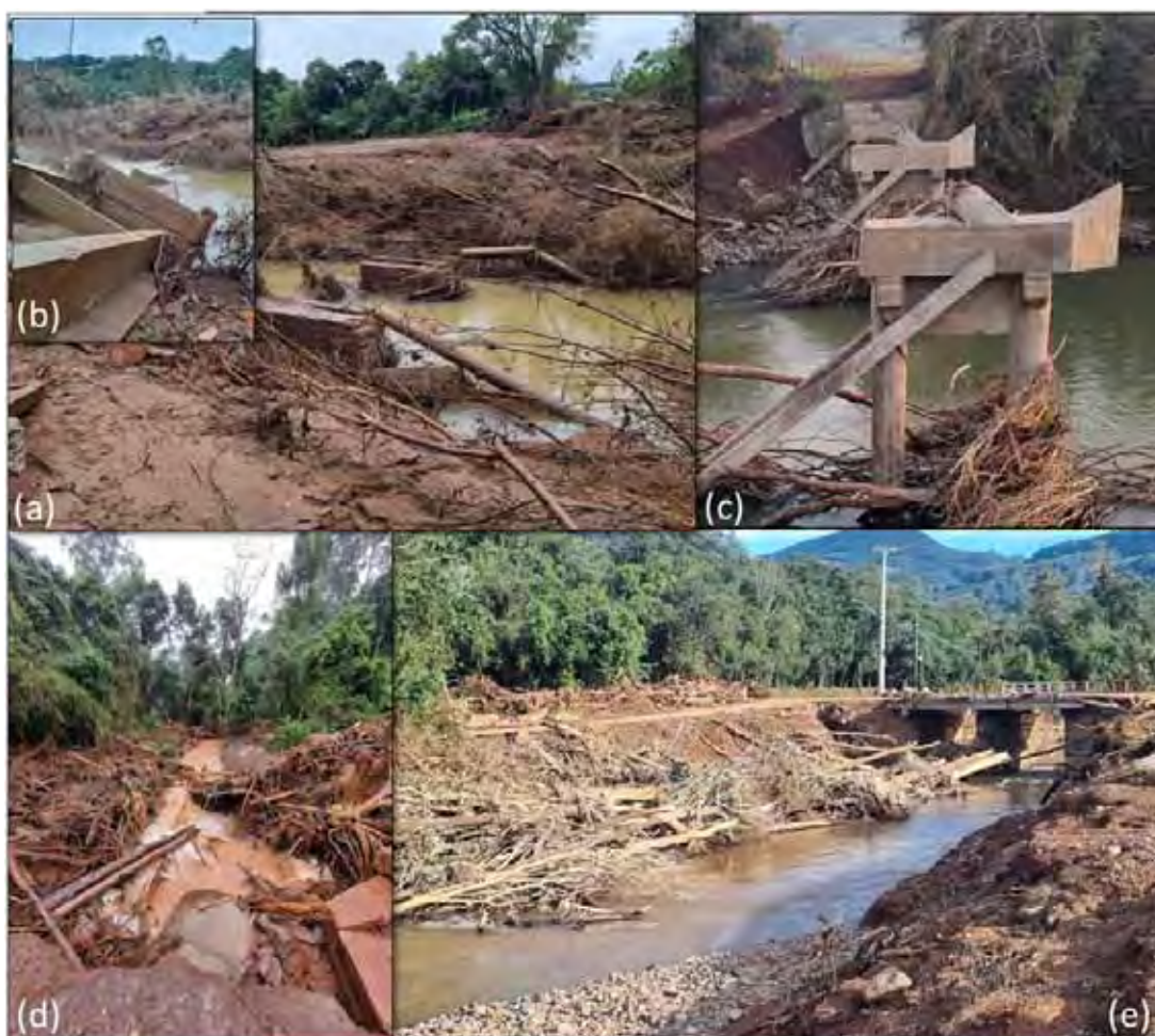
Figura 5. Exemplos de pontes e bueiros colapsados em pequena bacia. (a) Liberato Salzano; (b) Taluleiro da ponte colapsada; (c) Quevedos; (d e e) Bueiro e ponte em Imigrante
