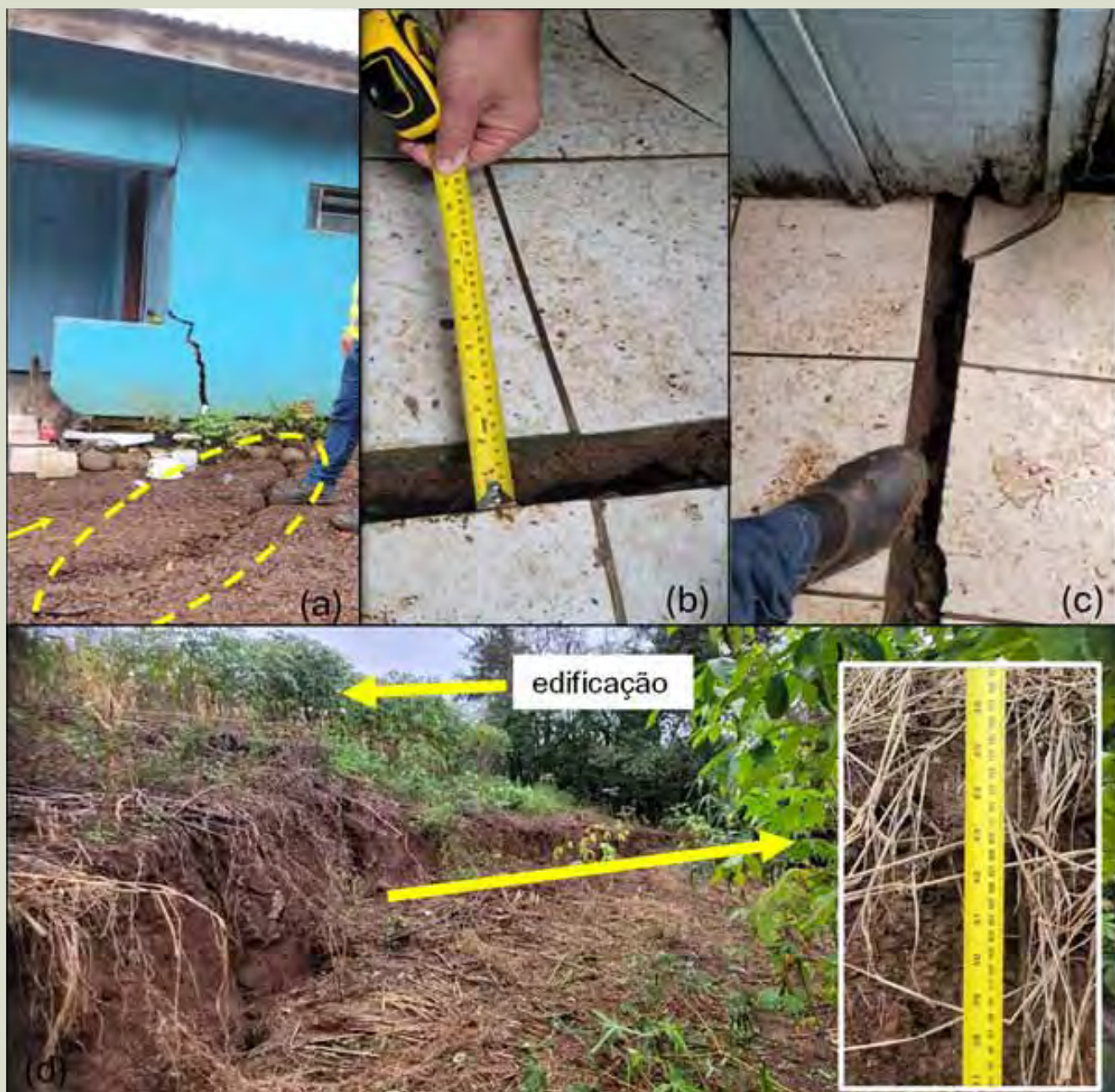
Figura 20. (a, b e c). Trincas na estrutura e piso da residência unifamiliar e (d) Degrau de abatimento no solo em grandes proporções (1,15m), encontrado no maciço abaixo da residência
