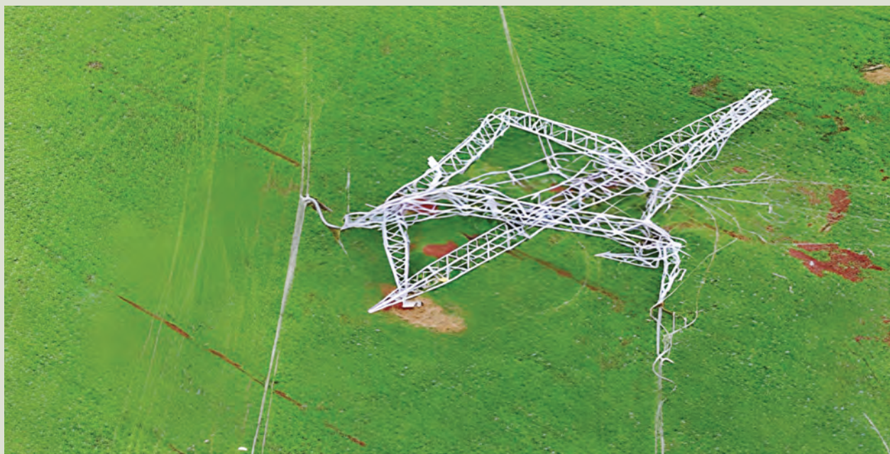
Figura 1. Ilustração dos danos na linha de transmissão da Ceee-Equatorial. Fonte: Eletrosul.
